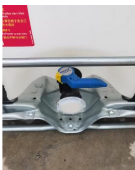
阀盖封堵后的状况
