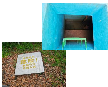
有少量泄漏物通过防渗漏沟流到集水井里
